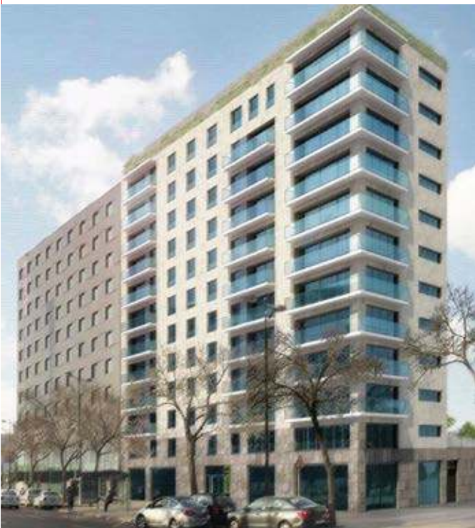
41 Viviendas, Avda. de Francia (Valencia) Sistema Instalado: Q-ton Bomba de calor con CO 2 y KXZ (VRF)
