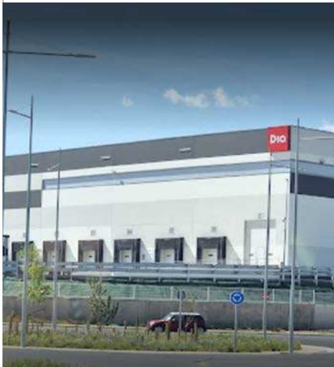
Almacén Central Supermercados Día (Illescas, Toledo) Sistema Instalado: Q-ton Bomba de calor con CO 2
